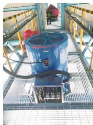
Air cooling island fan
